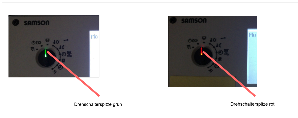
Bild 11: Anzeige einer Störung am Drehschalter
